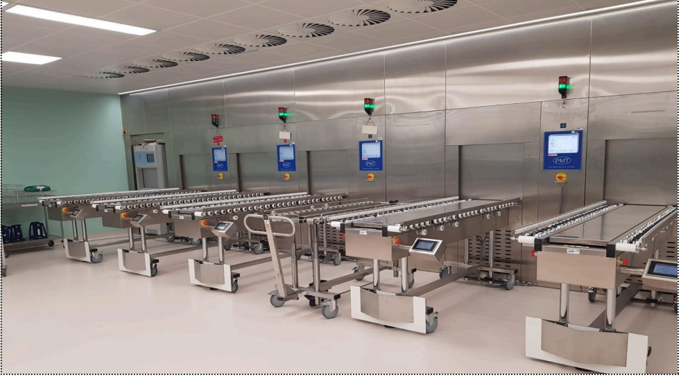
Şekil 2.9. Otoklavlar ve yükleme rampaları
